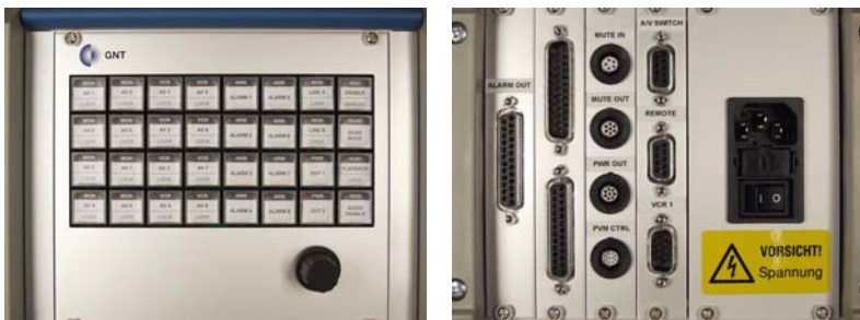
Bild 3 - zentrale Steuerung „C1“ Vorderseite und Rückseite
